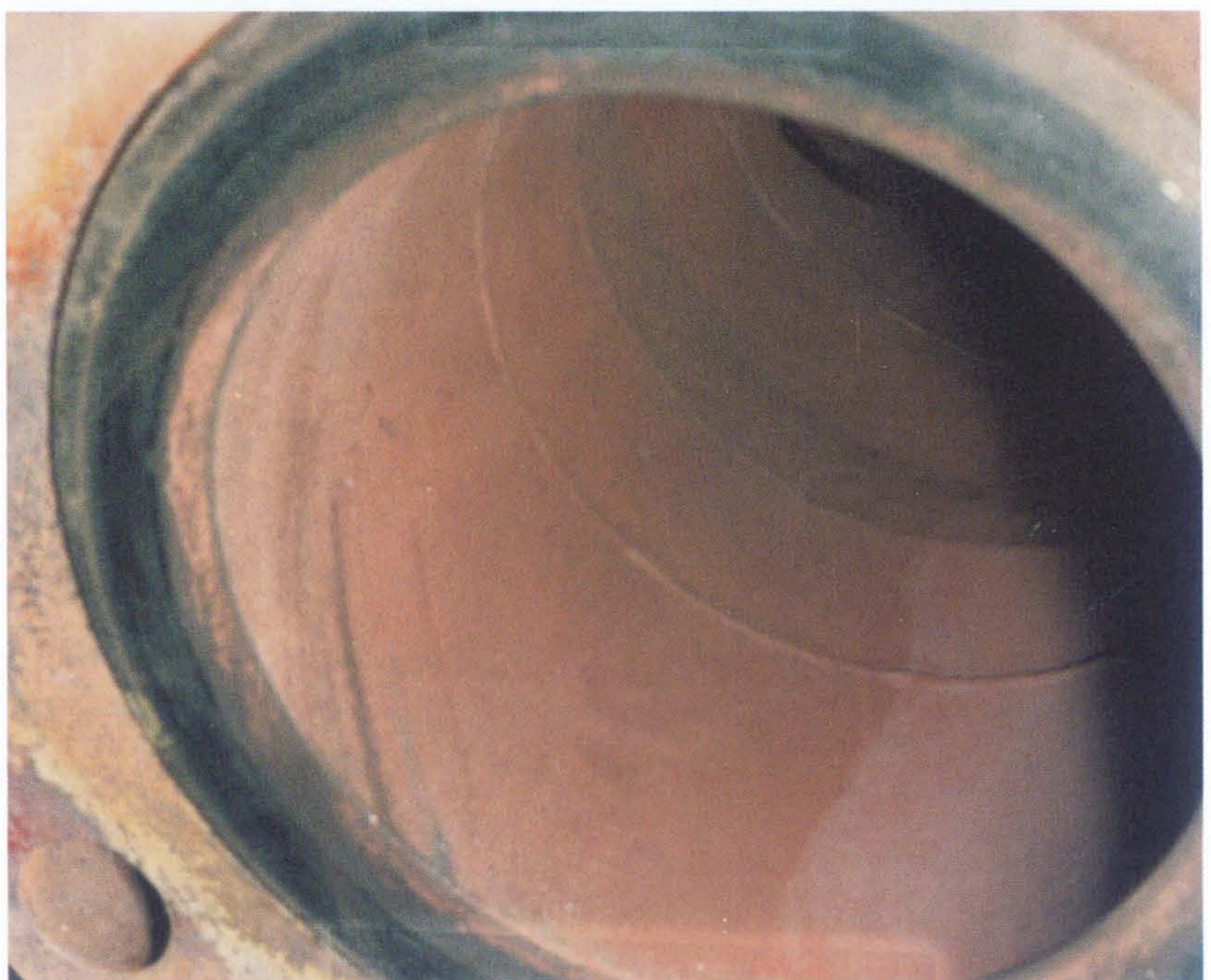
Konserviertes Rohrstück (Schutzwirkung im entleerten Zustand)
