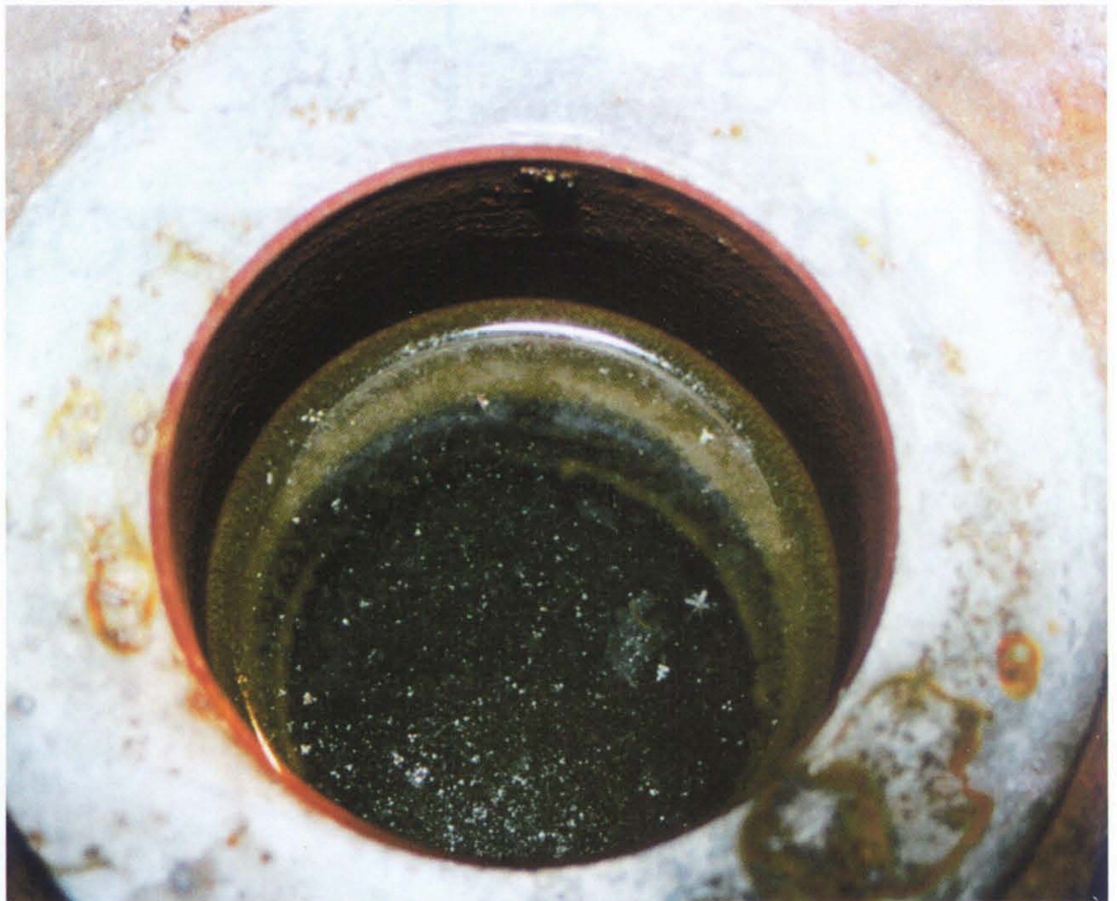
Konserviertes Rohrstück (Stand 8 Jahre mit Wasser gefüllt)
