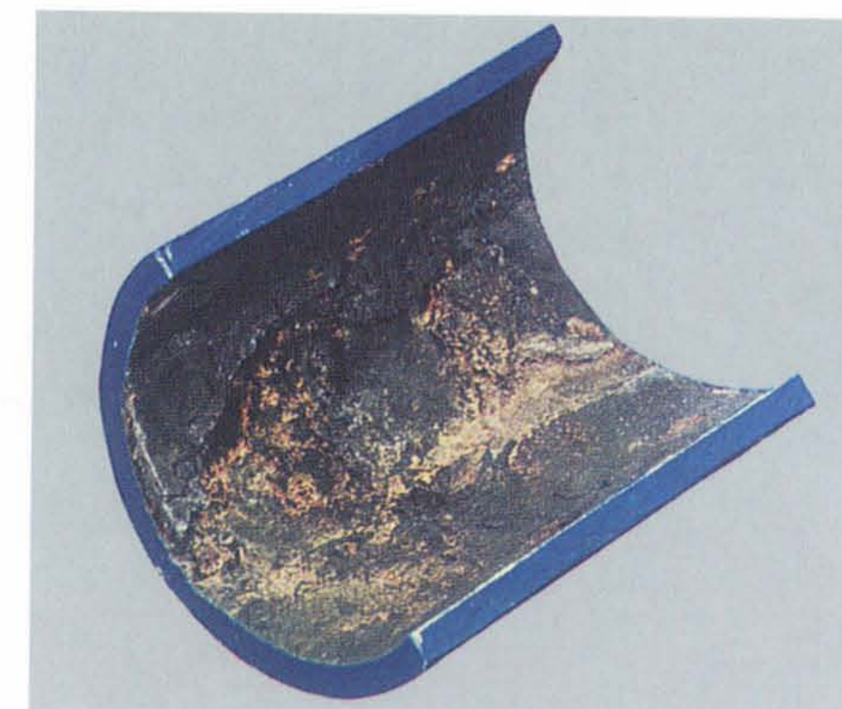
Abb. 3: Verdampferrohr vor der Reinigung
